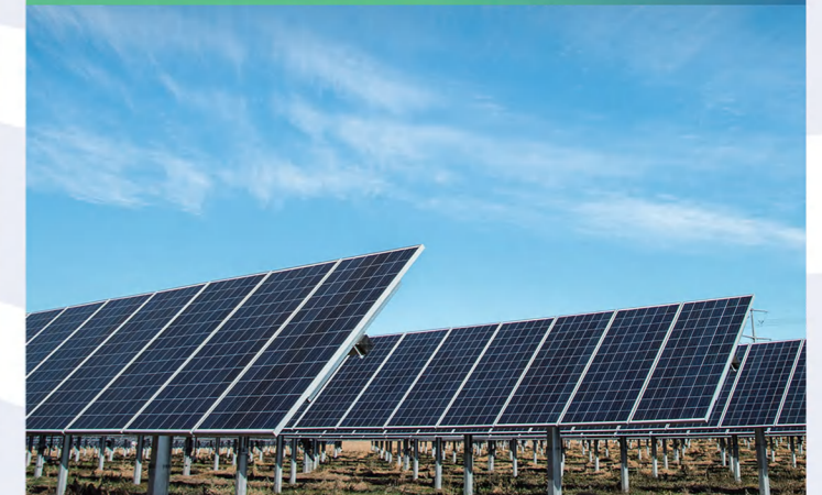
100MW 宁夏 银川
